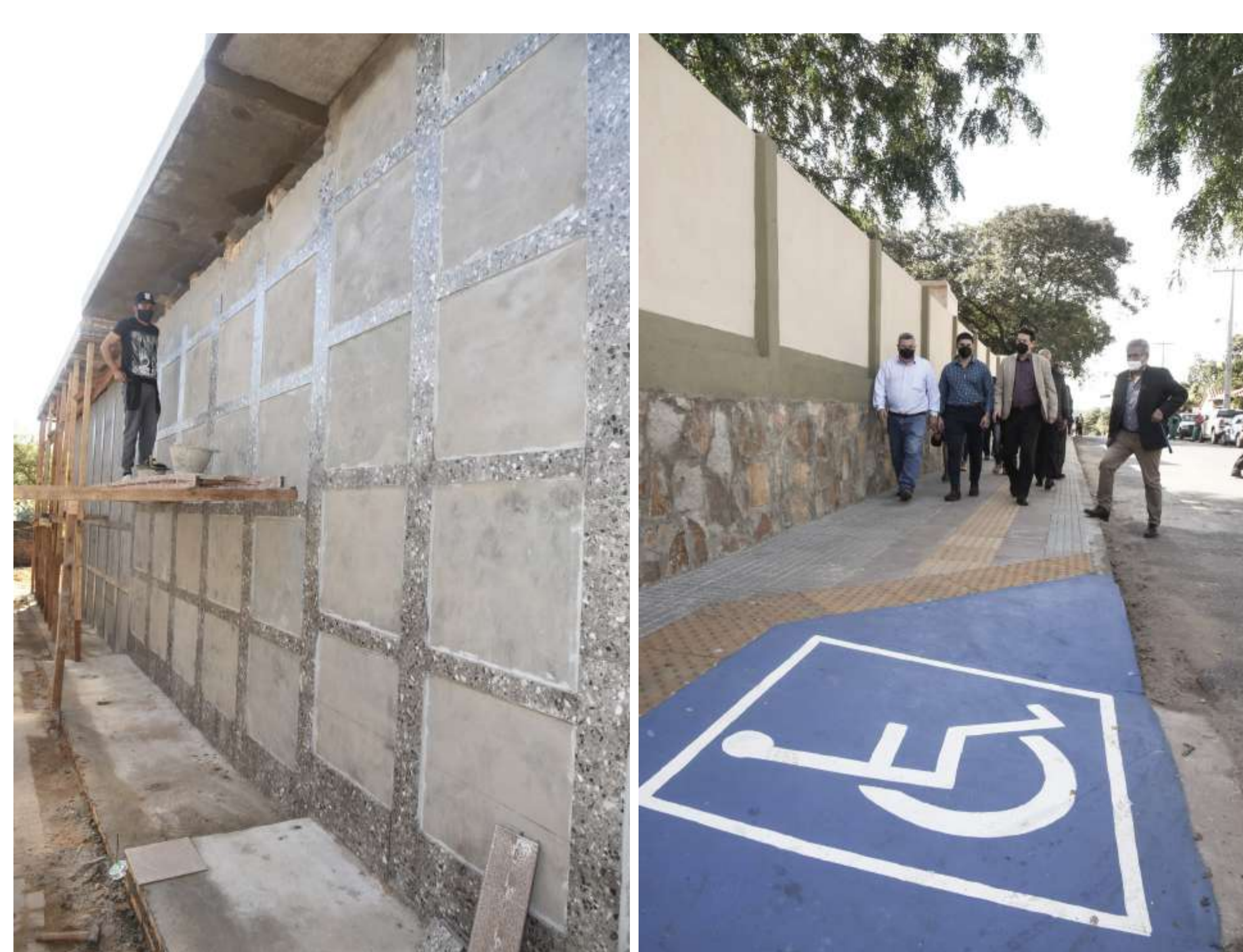
Mejoras - Cementerio del Este
