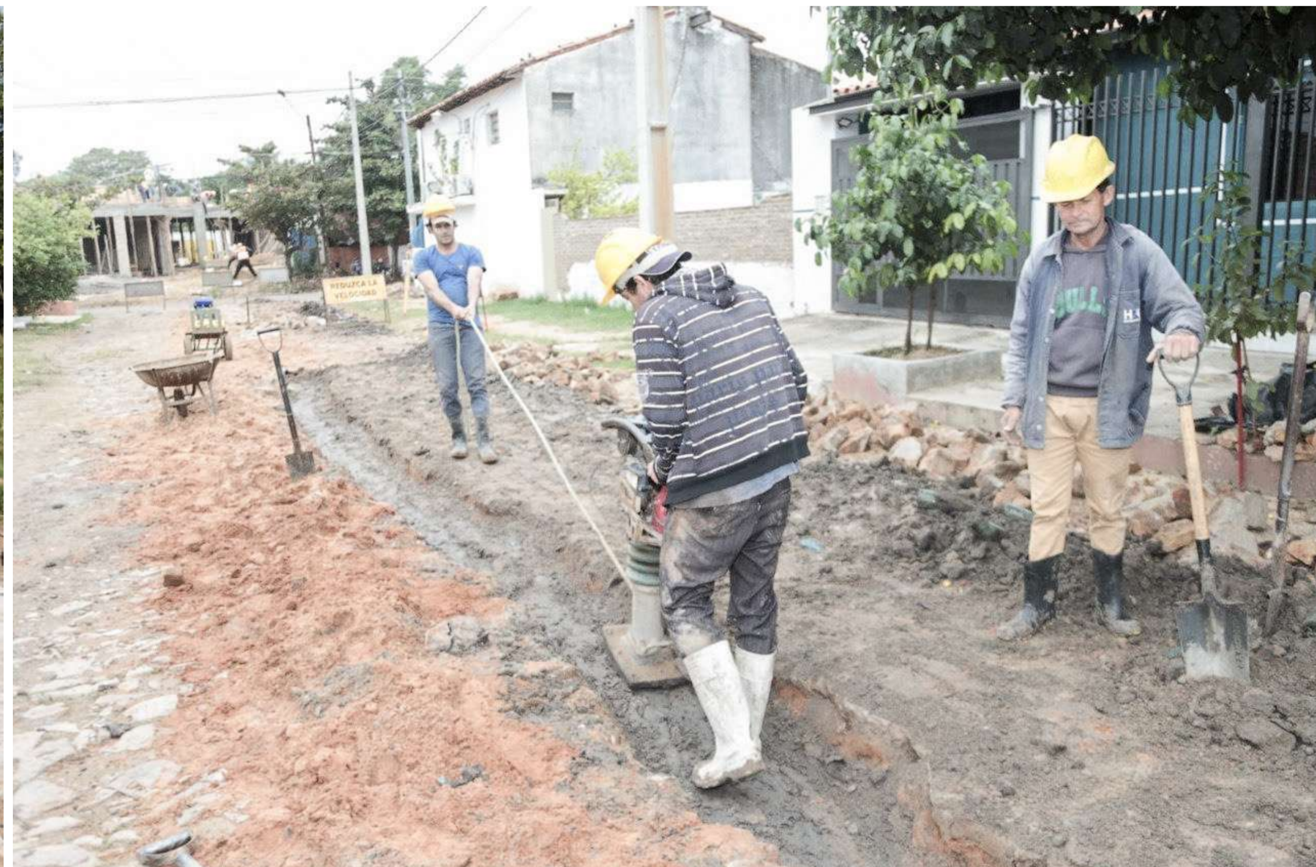
Alcantarillado Sanitario - Salvador del Mundo
